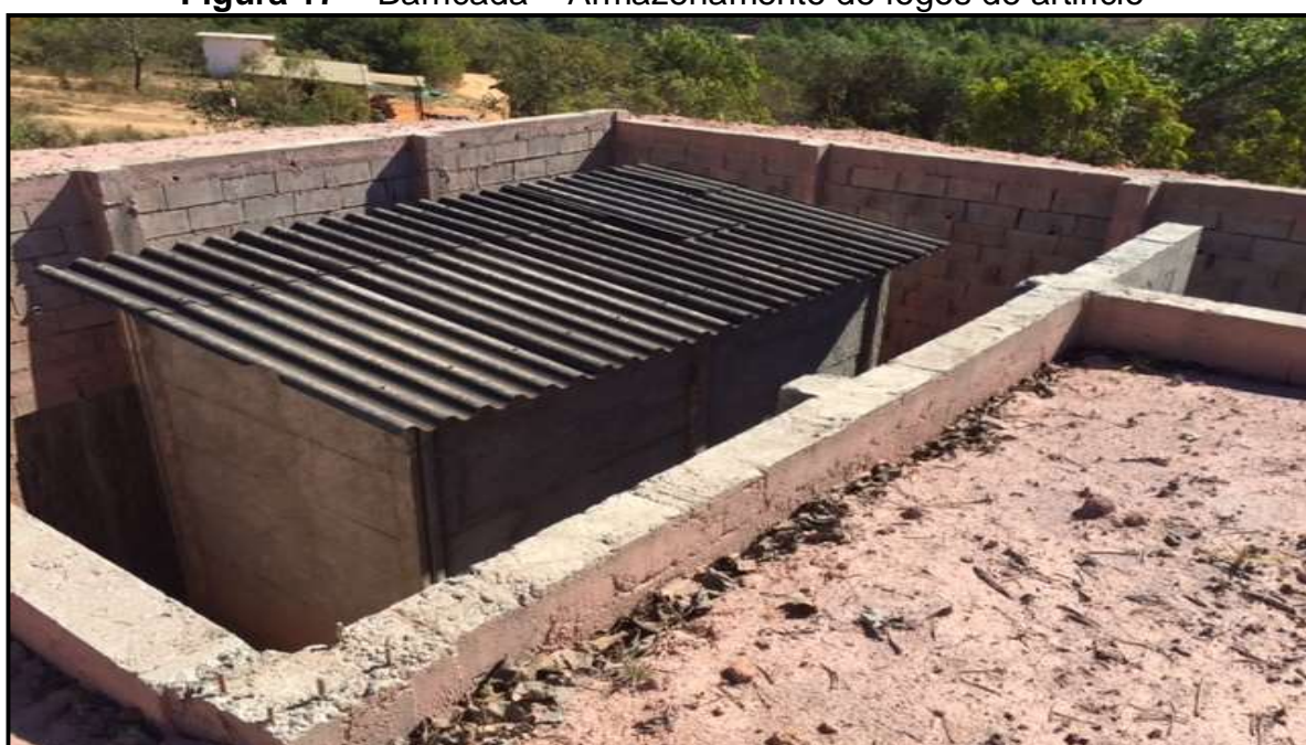
Figura 17 – Barricada – Armazenamento de fogos de artifício
