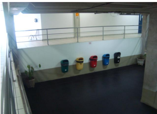
Figura 118. Coletores seletivos existentes na rampa, localizado no campus B.
