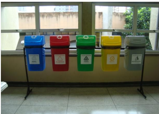
Figura 113. Coletores seletivos instalados no corredor do 1º andar do prédio A, localizado no campus A.
