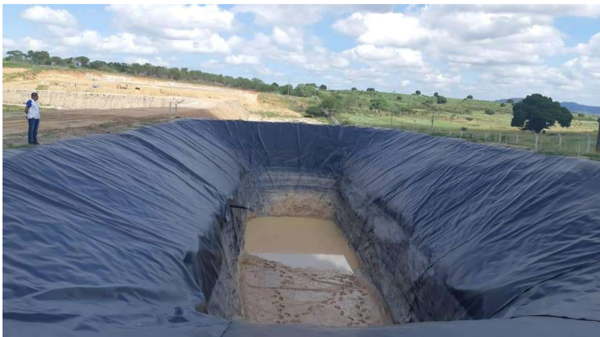
Figura 24 – Lagoa de Decantação do Aterro Sanitário Privado em Guarabira
