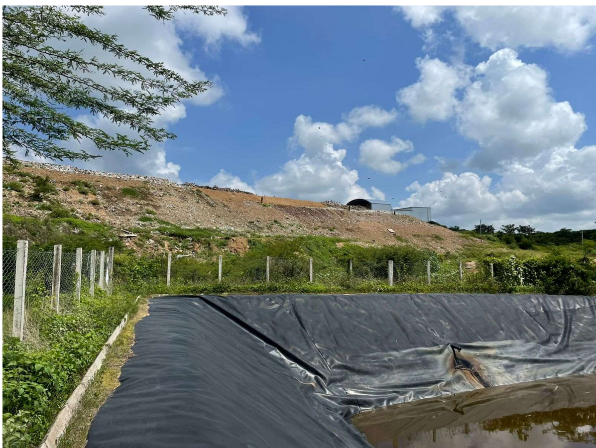
Figura 44 – Estação de Decantação no Aterro Sanitário Privado em Sousa
